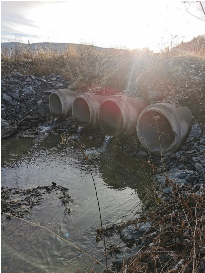
Figur 23: Kommunal kulvert før tiltak. Kulverten var delvis eller fullstendig vandringshinder for fisk i alle størrelser.
